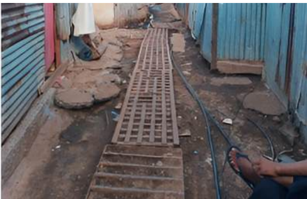
Plaques d'égouts "empruntées" par les habitants de la mangrove de Dembéné. Source : mission de terrain.
