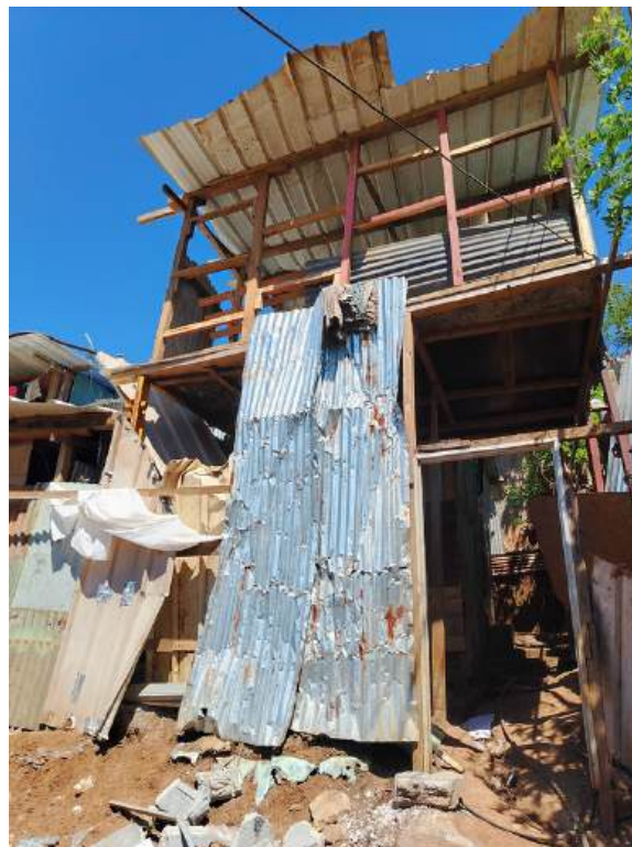
Maison sans fondations ni structure solide à Mahabourini. Source : mission de terrain.
