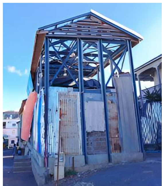
Logement LLTSA gravement endommagé par Chido. Source : mission de terrain.
